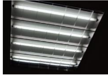
將傳統燈具 汰換為高效 能省電燈具
